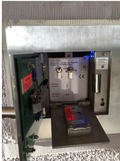
Innenansicht FSD 3 mit zwei überwachten Generalschlüsseln
